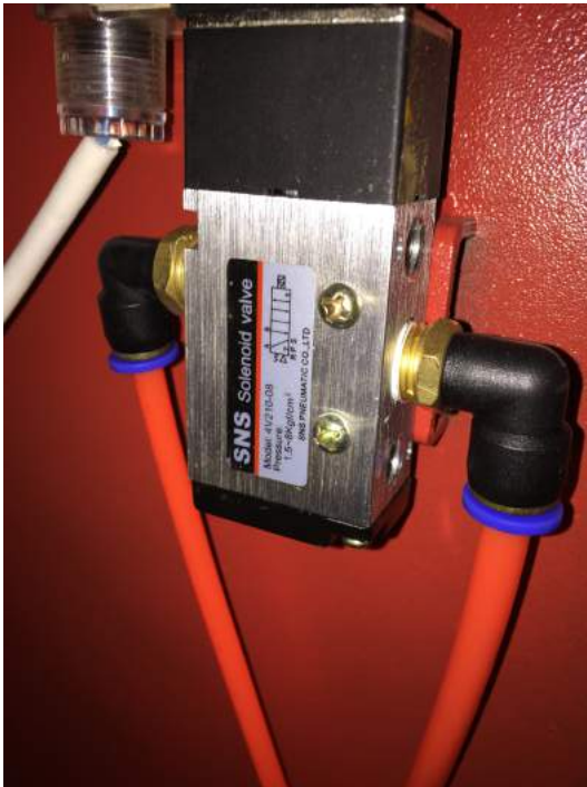
Fig. 3 – Tilslutning af luft inde i kontrolpanel
